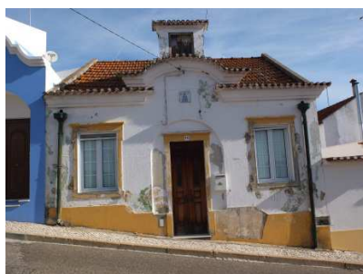
Figura 2 - Edifício primitivo do loteamento em mau estado de conservação
