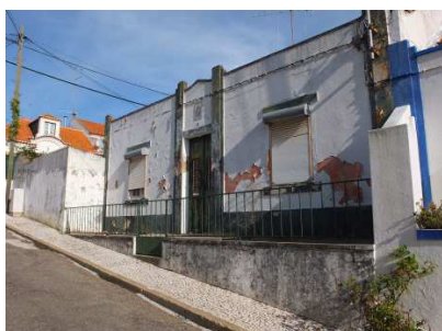
Figura 1 – Edifício primitivo do loteamento em mau estado de conservação
